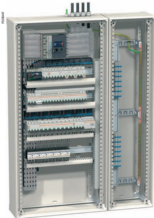
Вводной аппарат в силовом распределительном щите Prisma Plus G
